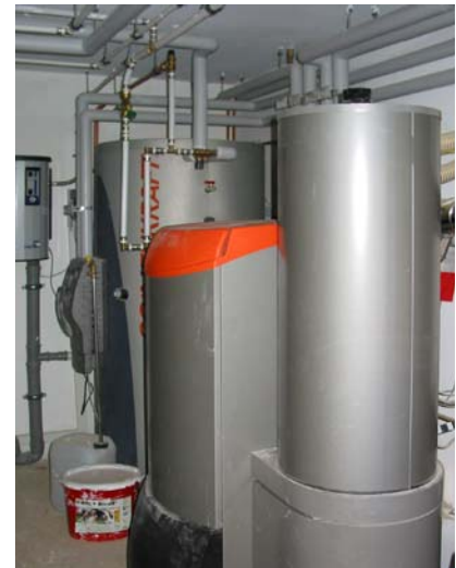
Die Holzpellets-Heizung ähnlich kompakt wie eine konventionelle Heizung
